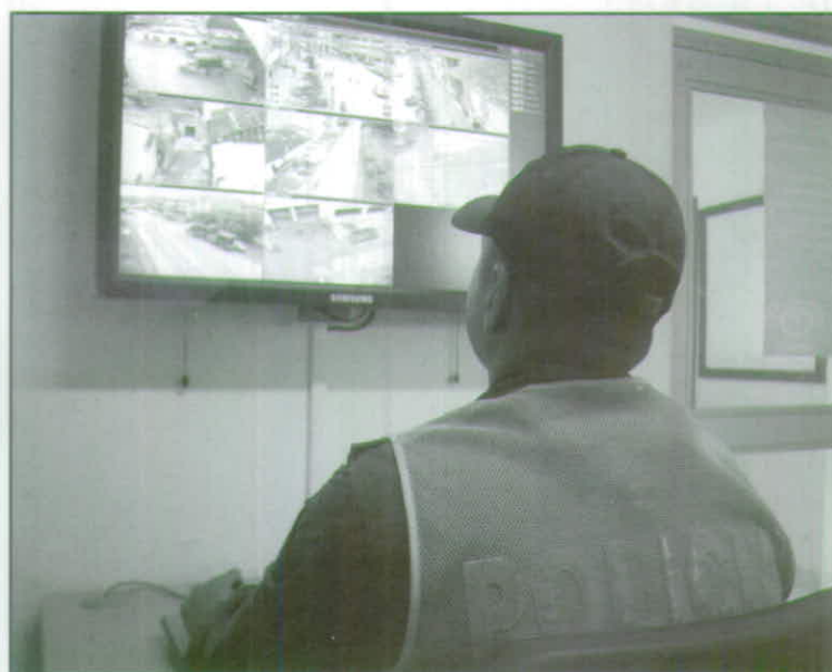
Centro de Control de Cámaras de Vigilancia.
