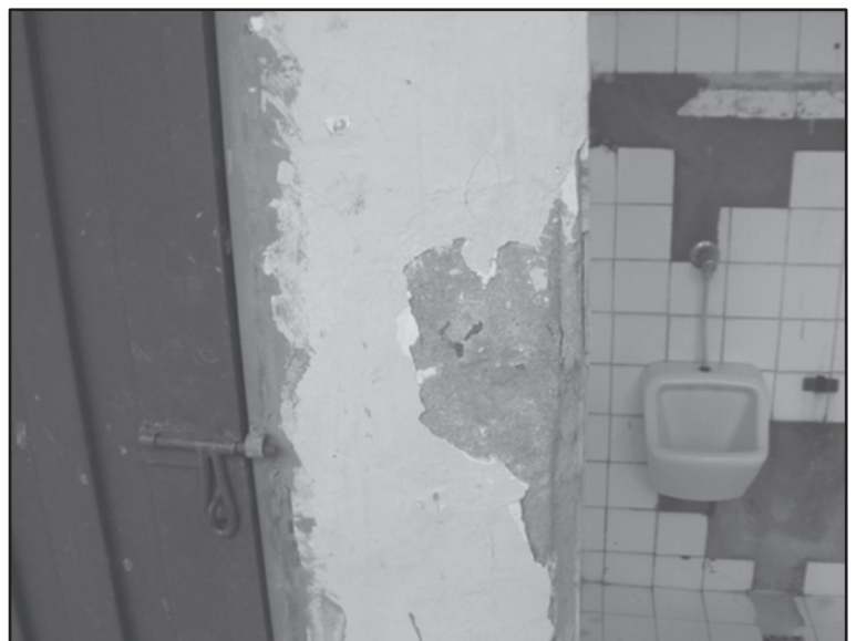
Muros enchapados en baldosin de orinal en mal estado
