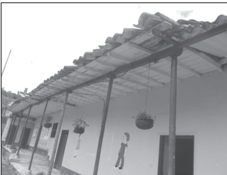
Cubierta en teja de barro en mal estado
